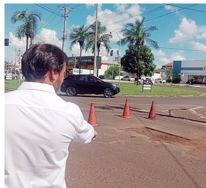
PERIGO IMINENTE: Buraco na rotatória de acesso ao bairro Paulo Prata
